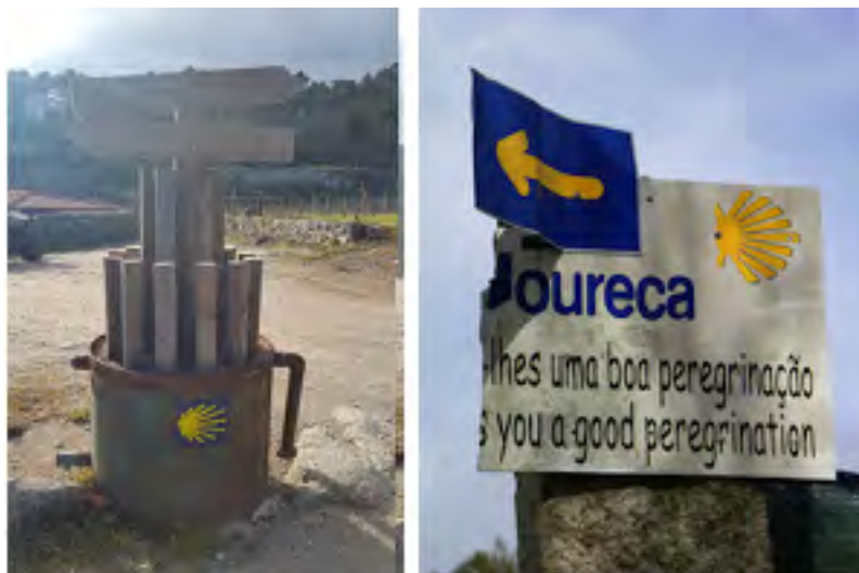
Ilustração 25: Sinais realizados com materiais inadequados e em mau estado de conservação. Fonte: elaboração própria
