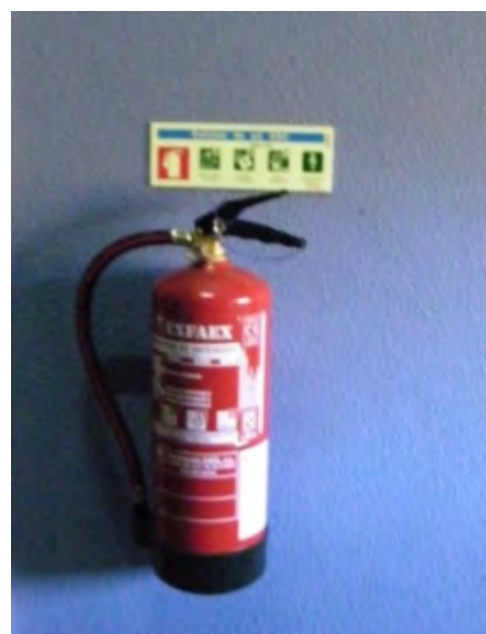
Ilustração 50: Extintor e sinalização no Mosteiro de Vairão
