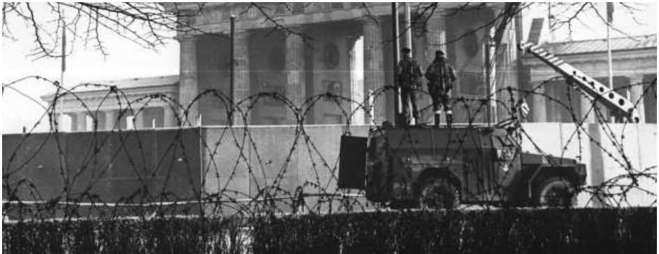
Gardas de Alemaña do Leste vixían os traballos de construción do Muro. Autor:CIA. Licenza: public domain.
